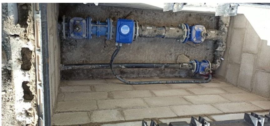
Figura 24. Imatge d'una arqueta amb un cabalímetre
