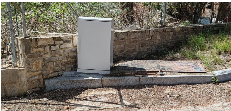
Figura 26. Imatge d'armari exterior amb arqueta al lateral
